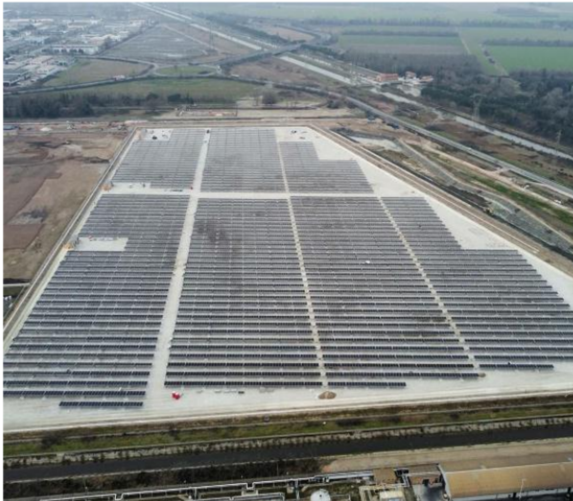
Una visione dell'alto del parco fotovoltaico: diecimila i pannelli solari installati e realizzati in silicio monocristallino
